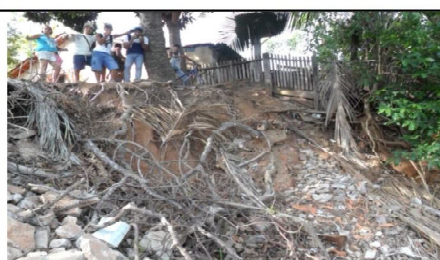
4- Processo erosivo nas margens do rio
